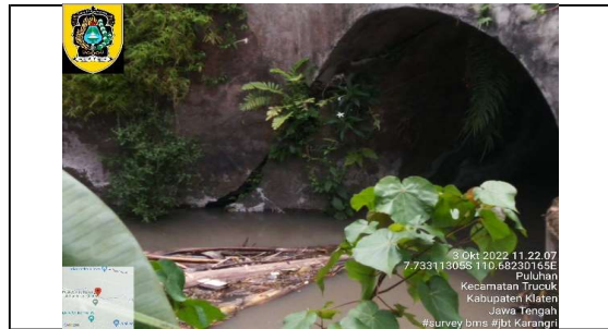
Bangunan pelengkung retak
