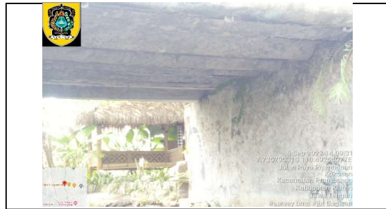
Gelagar terlihat tulangnya
