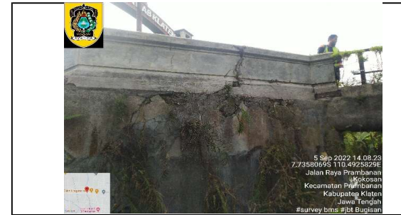
Bangunan sayap retak
